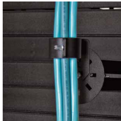
Kit di morsetti universali da rack installato
