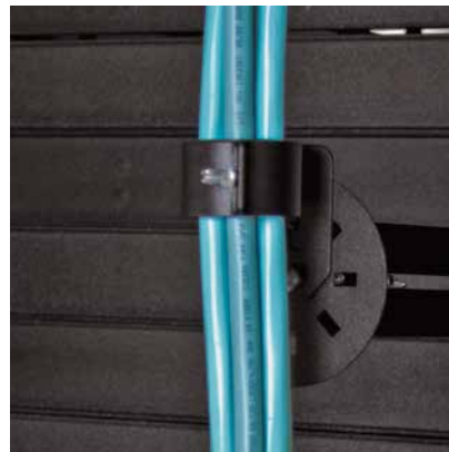
Rack-Montage Universelles Klemmen-Kit installiert
